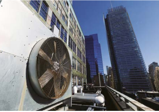
Frekans inverter kullanımından yararlanan fan uygulamaları
