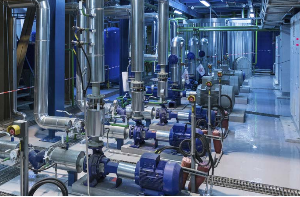
Bina otomasyonunda enerji tasarrufu sağlayacak şekilde frekans inverterleri ile çalıştırılan pompalar
